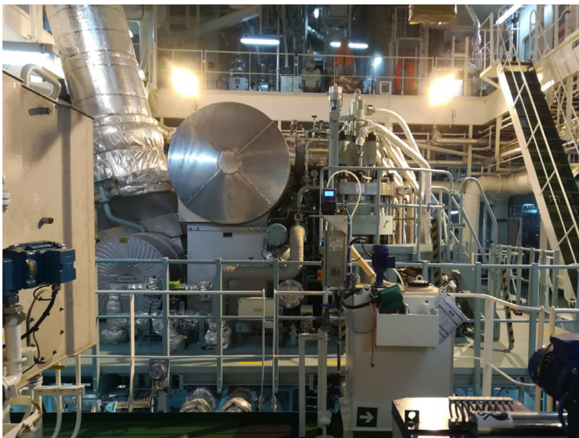
2.10. attēls. SIA "LSC" tankkuģa Elandra Redwood mašīntelpa
