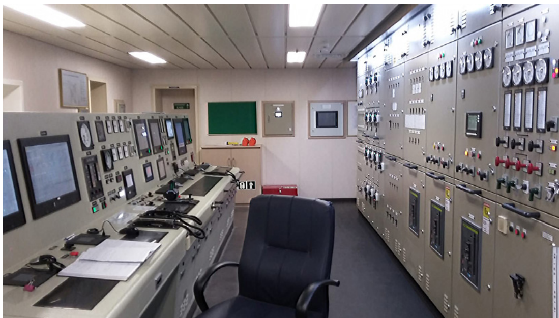
2.11. attēls. Centrālās vadības postenis mašīntelpā
